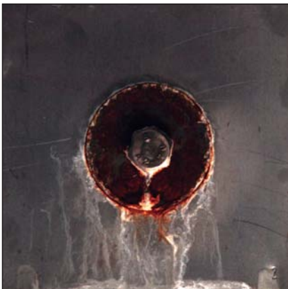
Kontaktbereich nicht abgedeckt. Rotrost-Bildung durch galvanische Korrosion.
